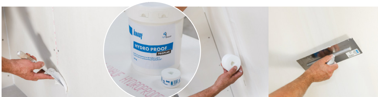
Enduisage et mise en place de la bande à joint Knauf HydroProof® avec l'enduit prêt à l'emploi Knauf Proplak® HydroProof® : facile à mettre en œuvre, pour un rendu très blanc et une finition parfaite.
